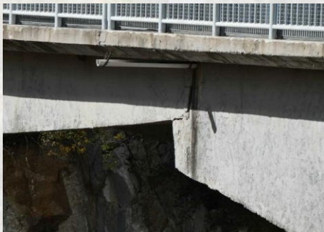
Dilavamento dal sistema di giunti
